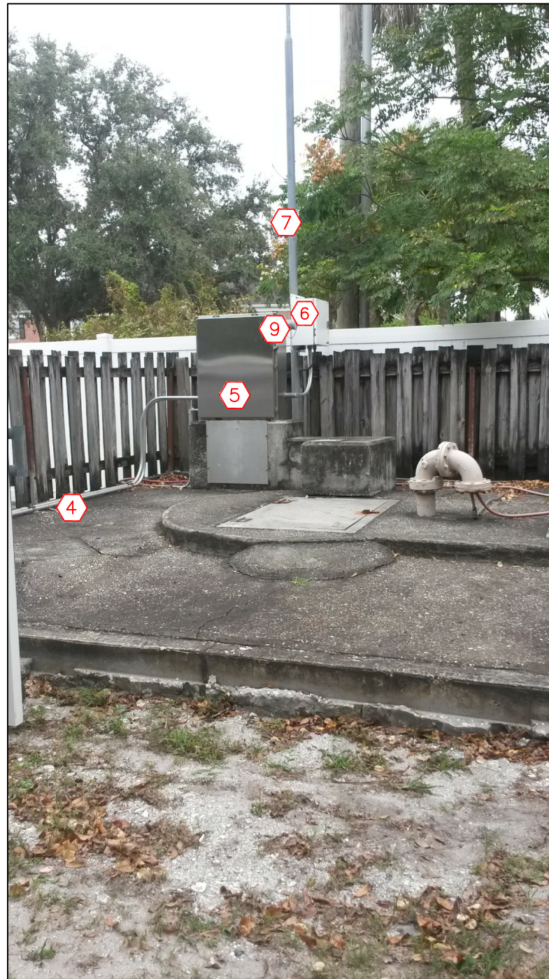
EXISTING CONTROL PANEL & SCADA ANTENNA SCALE: N.T.S.
